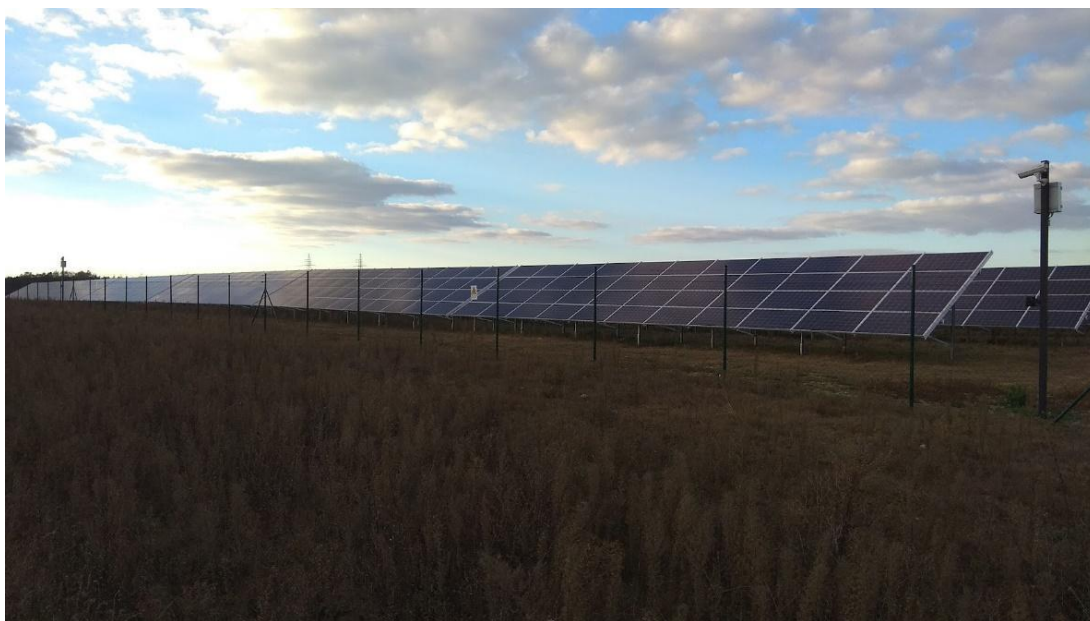
Widok na instalację fotowoltaiczną
