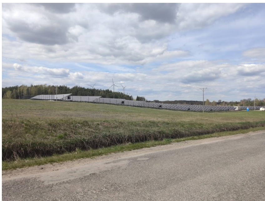
Widok na instalację fotowoltaiczną
