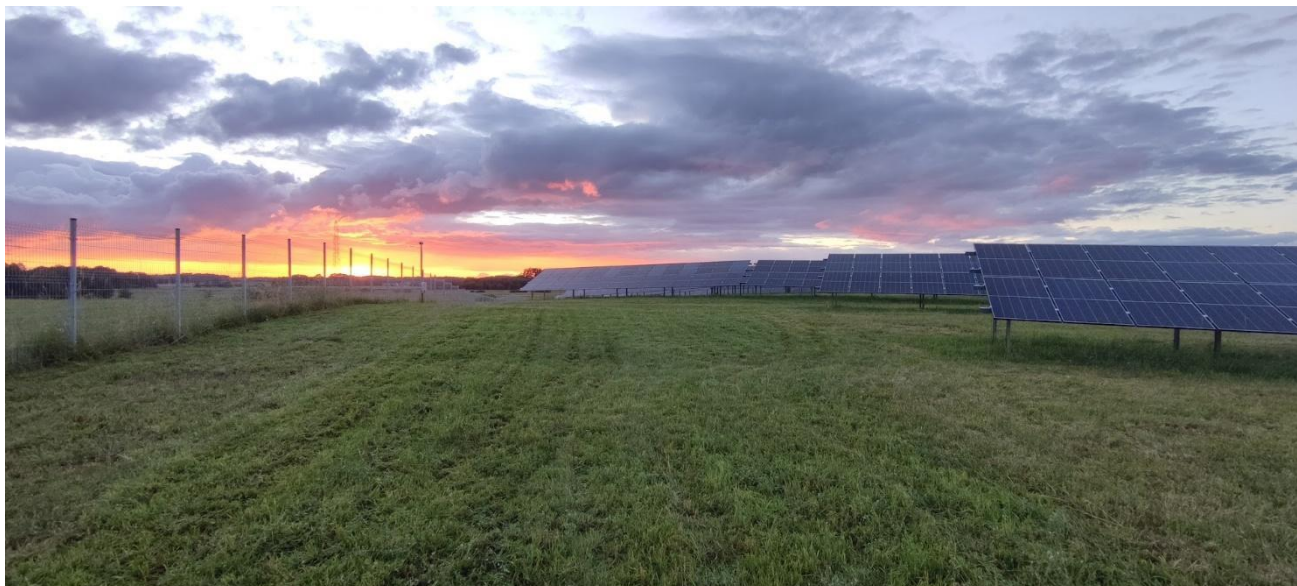
Widok na instalację fotowoltaiczną
