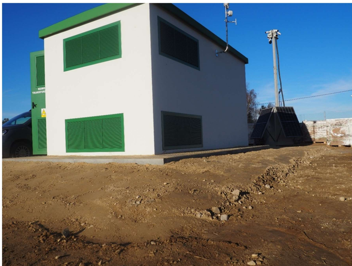
Ryc. 10. Przykładowa stacja transformatorowa (zdjęcie własne pochodzące z innej zrealizowanej farmy fotowoltaicznej).
