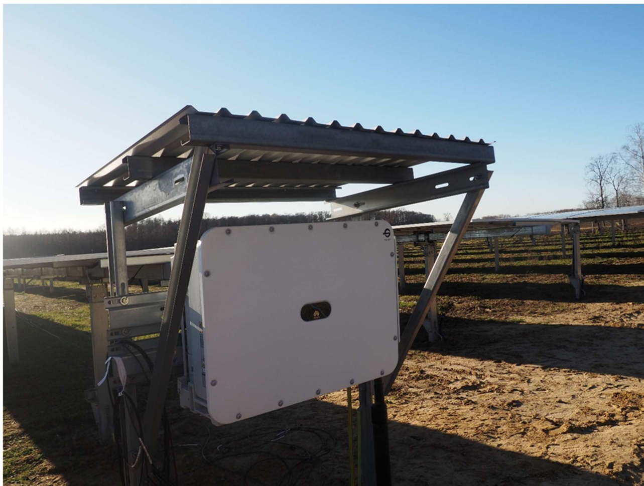
Ryc. 9. Przykładowy inwerter (zdjęcie własne pochodzące z innej zrealizowanej farmy fotowoltaicznej).
