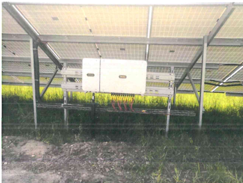
Rysunek 6. Falowniki (inwertery) zainstalowane na konstrukcji wsporczej.
