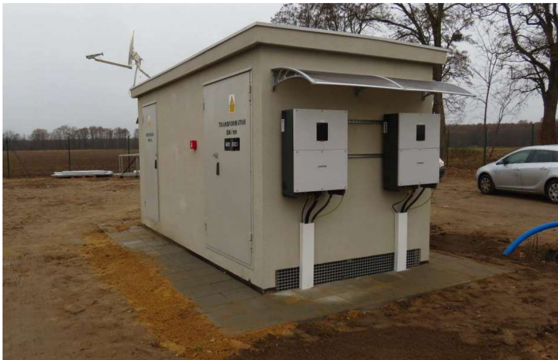
Ryc. 7. Falowniki (inwertery) zainstalowane na stacji transformatorowej SN Źródło: Materiały Inwestora
