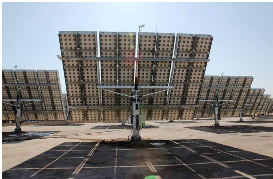
Ryc. 20 Przykład paneli fotowoltaicznych z dwuosiowym systemem trakcyjnym.
