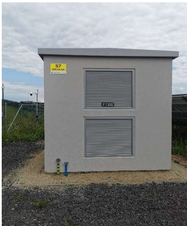
Ryc. 10. Przykładowy budynek kontenerowej stacji transformatorowej Źródło: Materiały Inwestora
